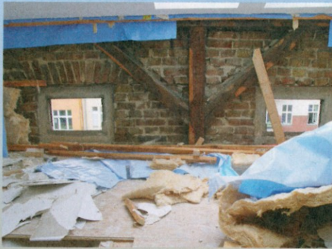
Freilegen und öffnen: Bei diesem Dachausbau war beides vonnöten, um später die besonderen Effekte zu bekommen. Auch der Fußboden wurde neu ...
