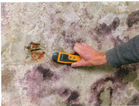
Wer bereits solch massive Feuchtigkeitschäden an seinen Hauswänden feststellt, braucht Hilfe von einer Fachfirma. Foto: Isotec
