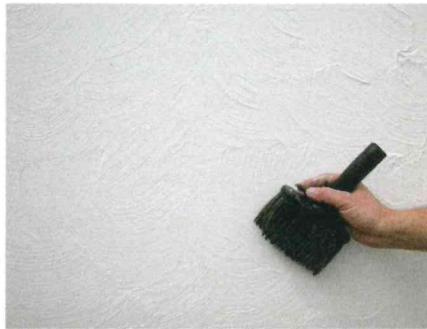
Mit einem großen Pinsel können schnell individuelle Strukturen in den noch feuchten Naturkalkputz gezogen werden. Foto: haganatur.de
